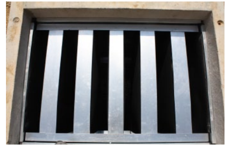
Oben: Blick in einen noch ungedämmten Lichtschacht für den Wärmepumpen-Ansug beziehungsweise -Ausblas. Unten: Schalldämmkulissen und Schalldämmmaten sind im gleichen Lichtschacht nun eingebaut.
